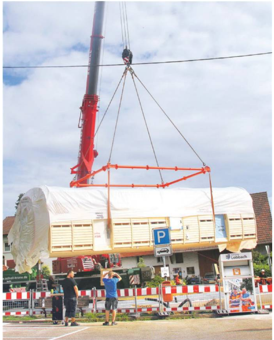
Ein Kran transportierte das Supermarkt-Gebäude an seinen künftigen Standort. Foto: A. Dorn
